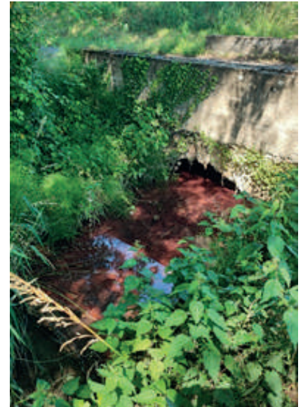
Hydrocarbures sortant du réseau des eaux pluviales avant intervention.
