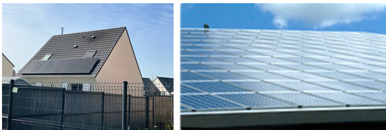
Figure 27 : Panneaux photovoltaïques produisant de l'électricité verte installés en toiture
